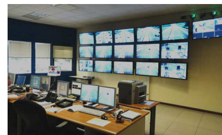
La sala controllo
